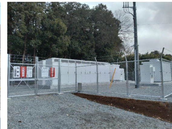
埼玉県日高市における蓄電所
