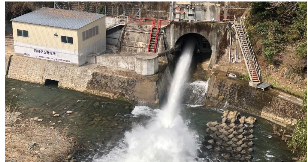
本社を含む3拠点に電力供給する四時ダム発電所（工営エナジーが運営）
