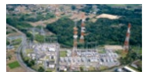
大容量送変電施設の整備 写真・新坂戸変電所
