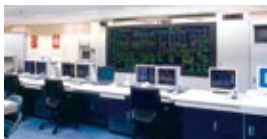
変電集中監視制御システムの開発
