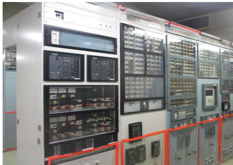
更新前遠方監視制御装置
