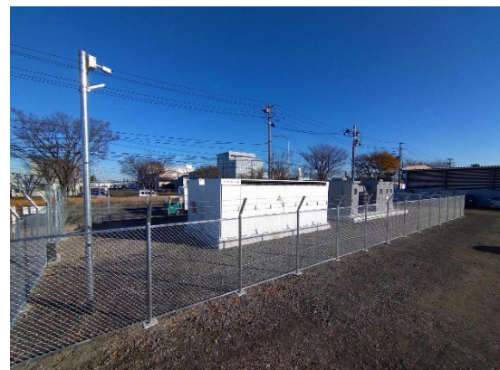
ミツウロコ宮城県仙台蓄電所
