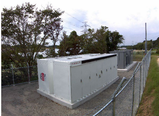
ミツウロコ愛知県田原蓄電所
