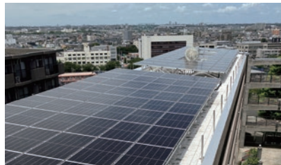
屋上に設置された太陽光パネル
