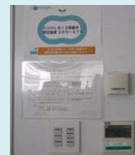
フロアの室温管理
