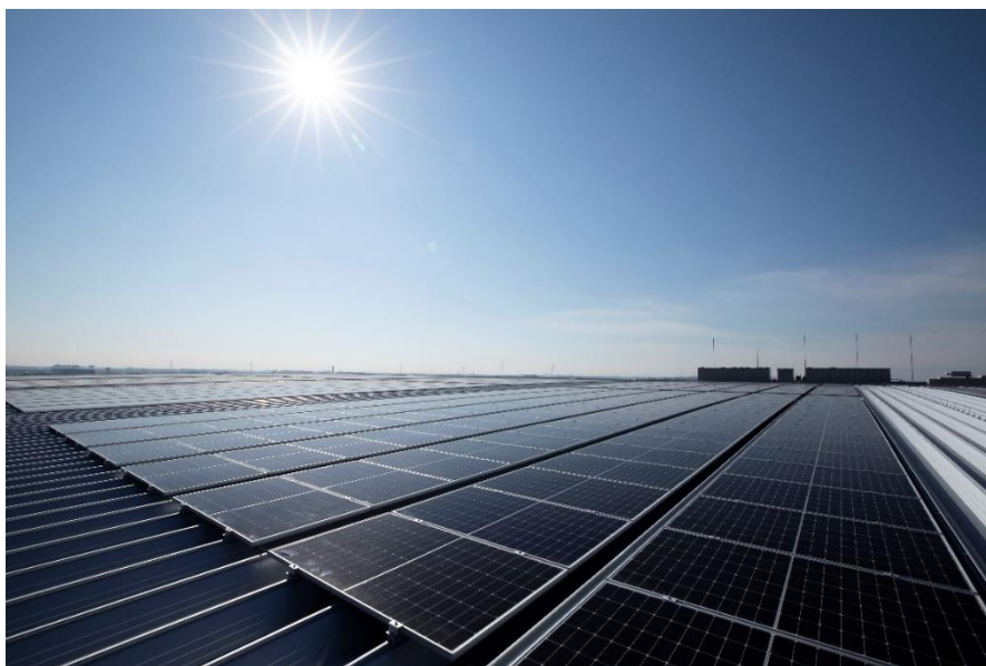
「T-LOGI 久喜」屋上太陽光パネル
