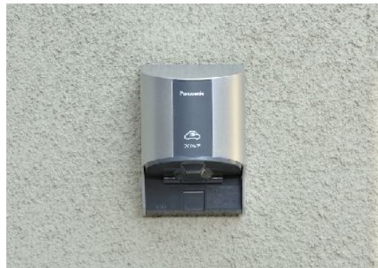
外壁面に設置した電気自動車対応コンセント
