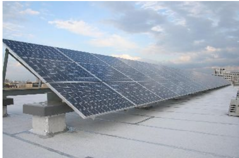
南棟屋上に設置された太陽光パネル
