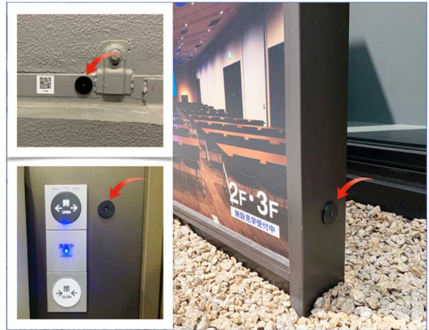
NFC タグの設置状況
