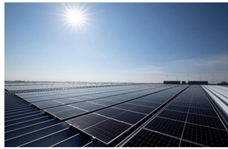
T-LOGI 久喜の屋根に設置された太陽光パネル
