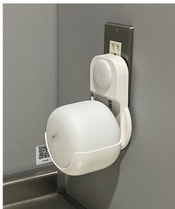
建物内に設置した Wi-Fi アクセスポイント（市販品）
