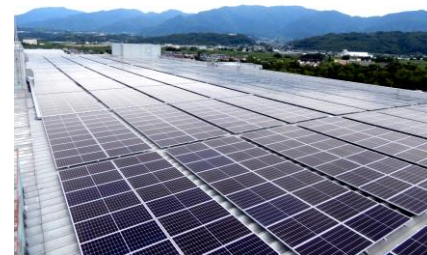
現地に設置した太陽光パネル
