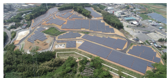
写真：五島市発電所の太陽光発電施設
