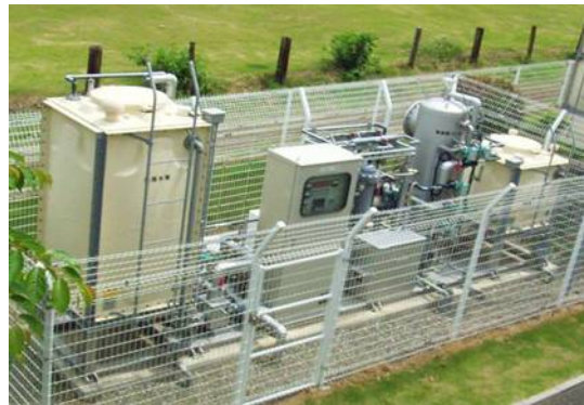
地下水膜ろ過システム
