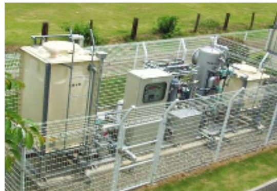
地下水膜ろ過システム
