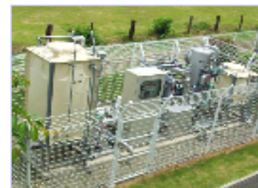
地下水膜ろ過装置
