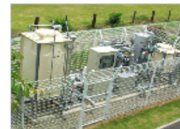
地下水膜ろ過装置
