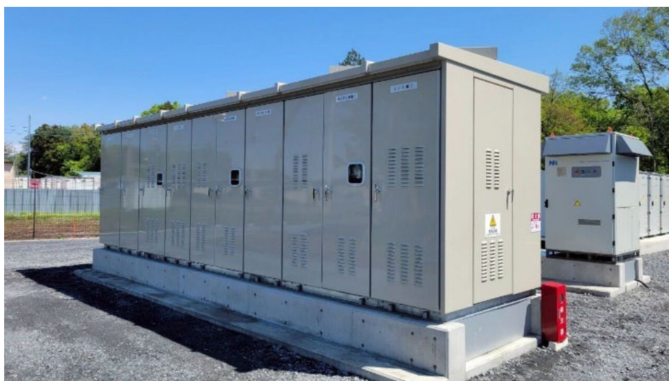
栃木県小山蓄電所
