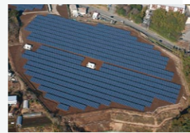
太陽光発電設備
