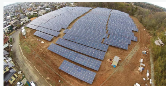
太陽光発電設備
