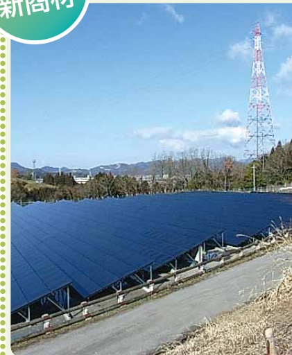
ソーラーフィールド日田太陽光発電所
