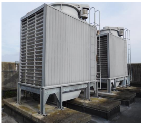
油焚冷温水発生機 冷却塔
