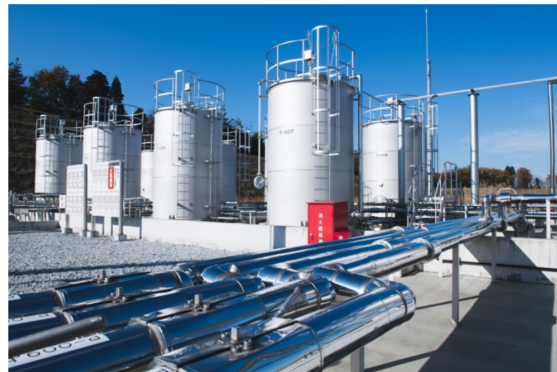
富山八尾工場屋外タンク
