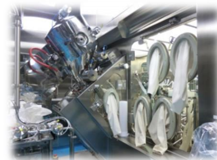
< 高薬理活性対応 の注射設備 >
