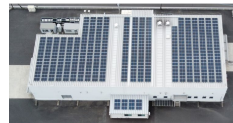
スターゼンミートプロセッサー(株) 阿久根工場 加工センター設置の太陽光パネル
