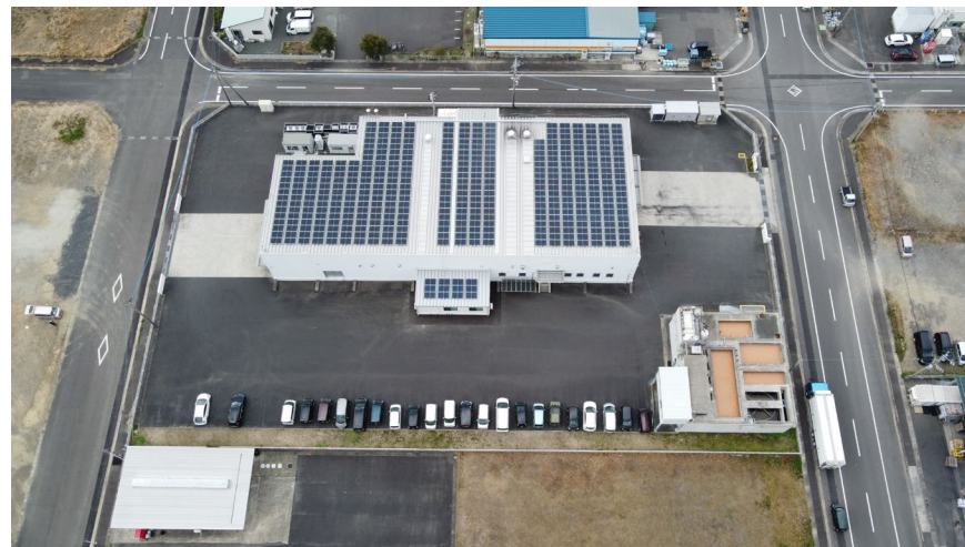
スターゼンミートプロセッサー(株) 阿久根工場加工センター 太陽光発電設備
