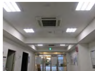
照明のLED化 (安土工場)
