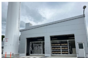
水素変換装置 (電気→水素)
