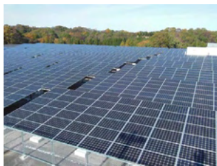
エルナー白河太陽光発電所
