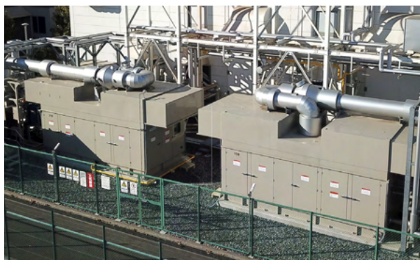
コージェネレーションシステム
