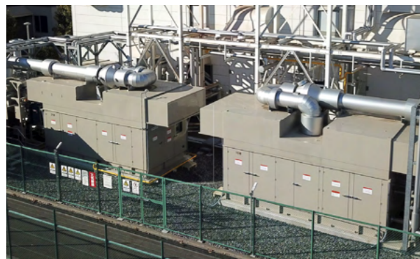
コージェネレーションシステム
