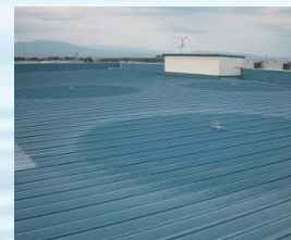
太陽化学工業（藤岡工場）の屋上散水システム
