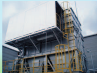
溶剤排ガス処理装置
