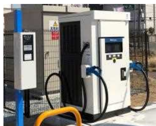
※関西電力実証実験のため、 コーナン西宮今津店への設置例
