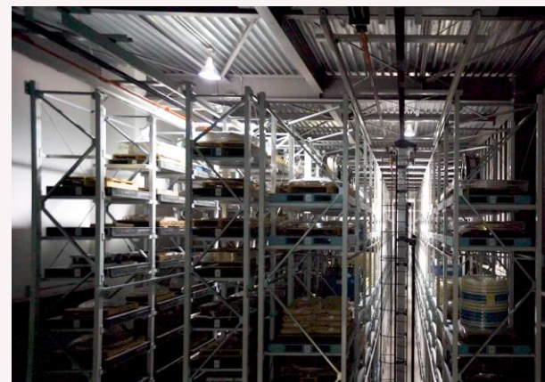
自動立体倉庫：搬送システム
