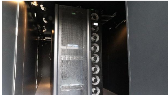
コンテナ型 DC の内観
