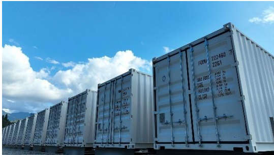
コンテナ型 DC の外観
