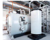
●ポンプ実験室
