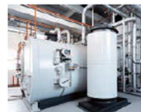
●ポンプ実験室
