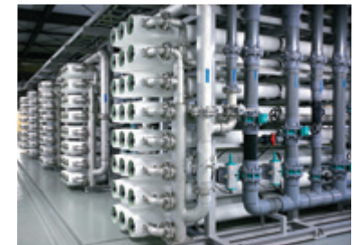
薬品が使用されるRO膜処理装置
