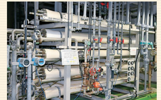
大分キャノンマテリアル(株)様 クローズドシステム設備
