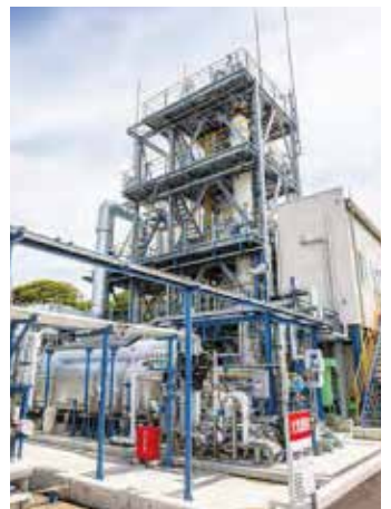
塩酸回収設備
