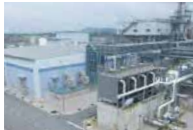
ゼオライト製造設備
