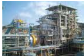
固形廃棄物焼却設備
