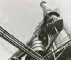
排煙脱硫装置
