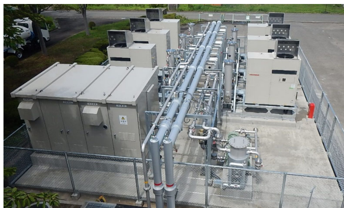
消化ガス発電設備
