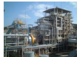
固形廃棄物処理設備
