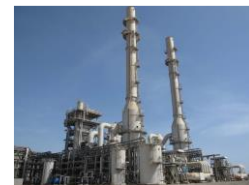
廃液燃焼システム
