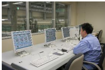
浄水場オペレーター室
