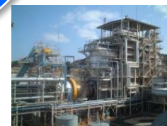
固形物焼却設備
