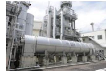
下水汚泥燃料化設備 (熱技術)
