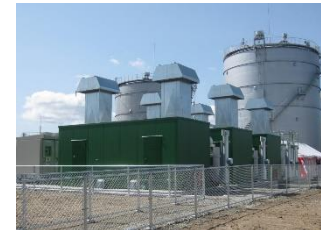
消化ガス発電設備 (消化関連)
