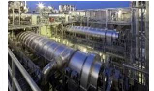
下水污泥 燃料化システム
