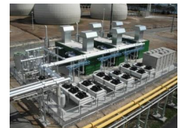
消化ガス発電事業
