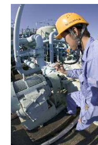
設備メンテナンス
