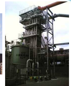
排煙脱硫設備
