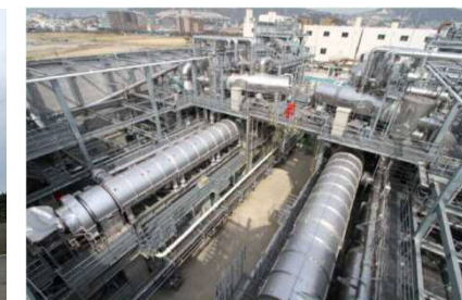
下水汚泥燃料化システム
