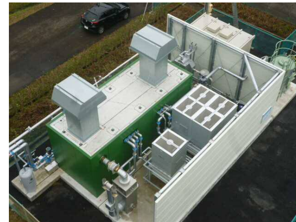
消化ガス発電設備
