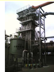
排煙脱硫設備
