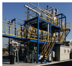
汚泥燃料化システム
