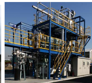
汚泥燃料化システム
