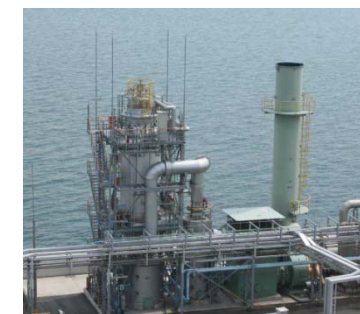
廃液燃焼設備
