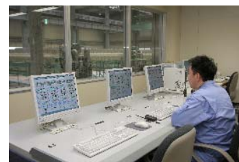
処理場オペレーター室
