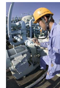
設備メンテナンス
