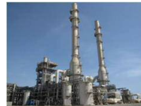
廃液燃焼システム
