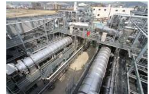
下水汚泥燃料化システム
