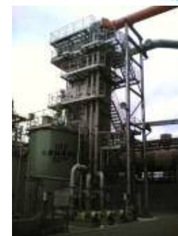
排煙脱硫設備
