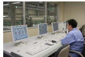
処理場オペレーター室
