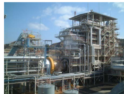
固形廃棄物処理設備
