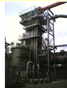
排煙脱硫設備
