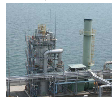
廃液燃焼設備
