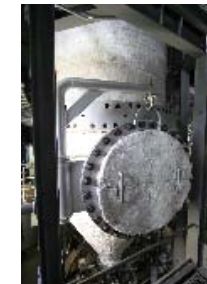
過給式流動 燃焼システム
