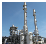
廃液燃焼設備
