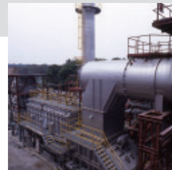
「一般廃棄物焼却設備」
