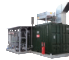
⑧消化ガスを燃料として発電するガスエンジン
