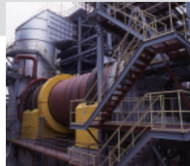
「産業廃棄物焼却設備」
