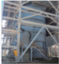
海水法排煙脱硫設備 (モロッコ)
