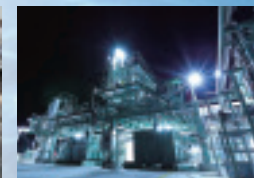
⑦B-DASH実証研究を進めている汚泥の脱水乾燥システム
