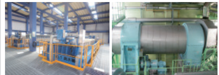
③濃縮した浄水汚泥を脱水し減容化する「加圧脱水機」
