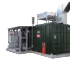
⑥消化ガスを燃料として発電するガスエンジン
