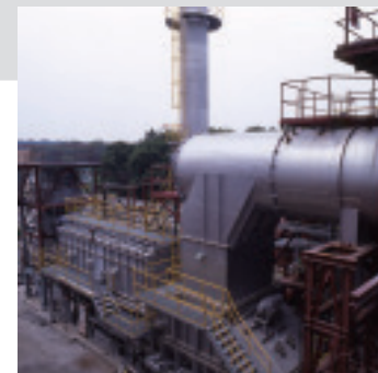
「一般廃棄物焼却設備」
