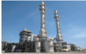
廃液燃焼設備 (サウジアラビア)
